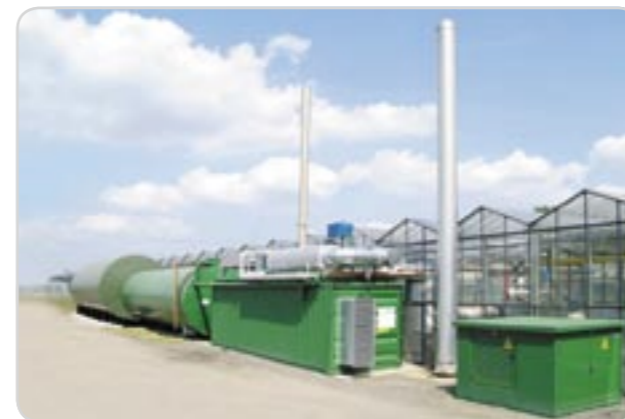
Блочная ТЭС на растительном масле, г. Гельдерн
